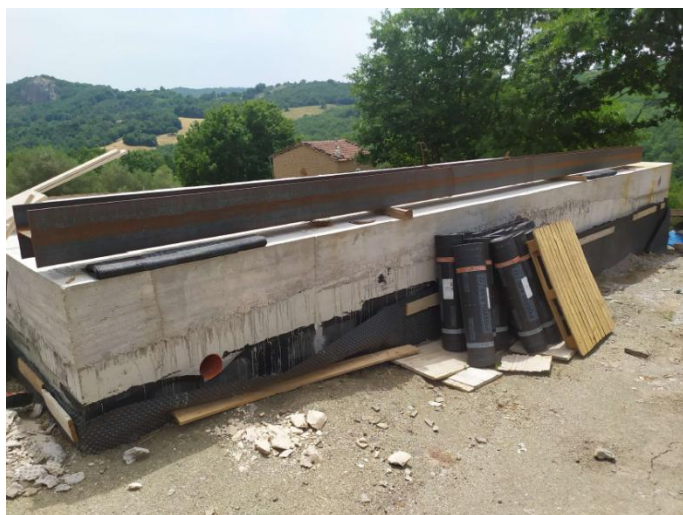
Cisterne di raccolta acque piovane
