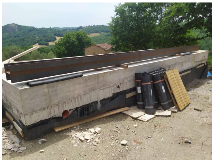
Cisterne di raccolta acque piovane
